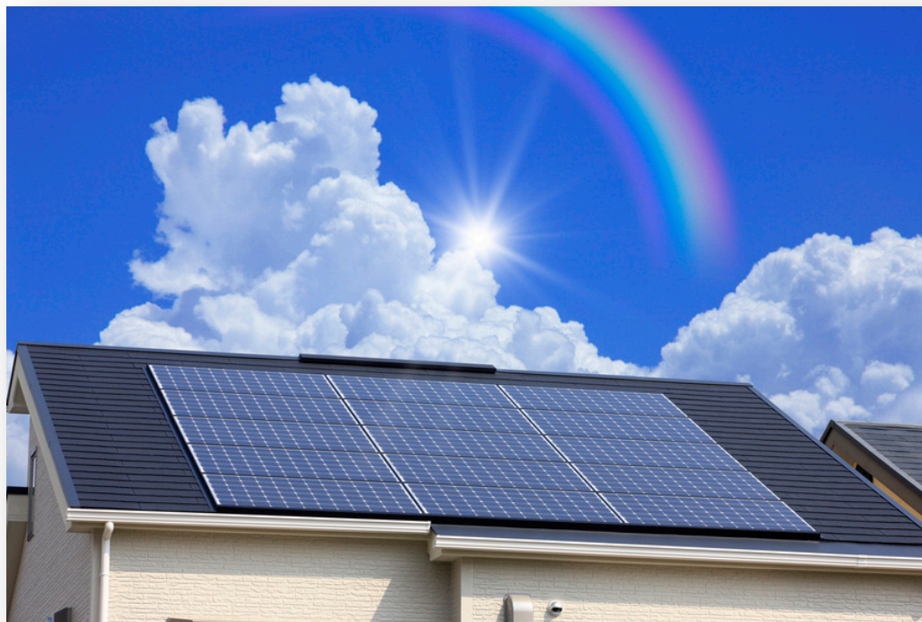
家庭への太陽光発電設備導入
